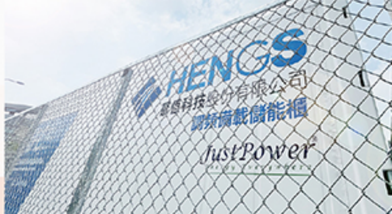
▲聚恆 AFC 調頻備載儲能系統，容量 2MW
