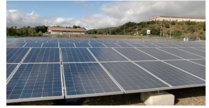
日本宇治田原太陽能發電站 / Ujitawara Power Station
