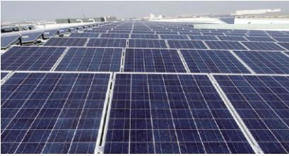
君帆工業股份有限公司 Jufan Industrial Co., Ltd
