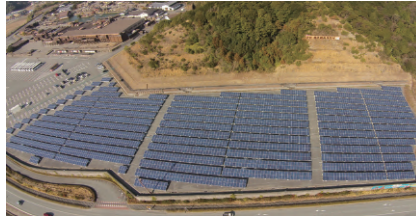
日本伊勢市太陽能發電站 se-shi Power Station
