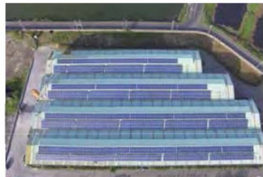
設置在城西固化廠屋頂的太陽能光電設備，設置容量為0.491MW。
