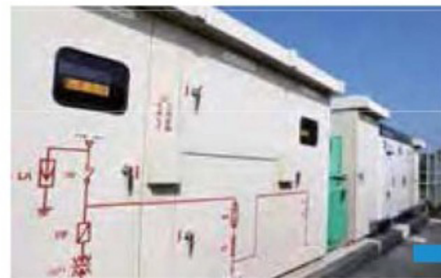
城西垃圾掩埋場的太陽能電錶箱。
