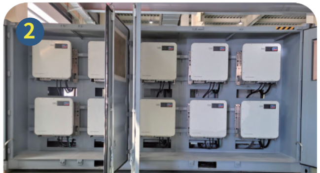
太陽能直流側機電貨櫃
