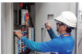
ACP盤檢查 - 電壓電流量測 Inspection ACP - IV Measurement
